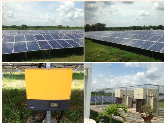
ภาพโรงไฟฟ้าพลังงานแสงอาทิตย์จากสถานที่จริงของ RSUN โครงการ 1 และ 2
